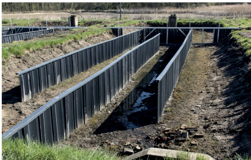
Rys. 7.23. Widok na kurtyny podłużne i poprzeczne oraz miejsce instalacji krat dopływowych i odpływowych.
