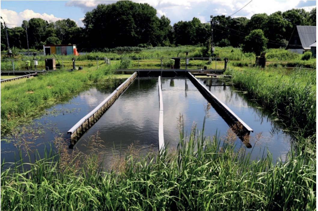
Rys. 7.26. Widok na strefę uzdatniania wody.
