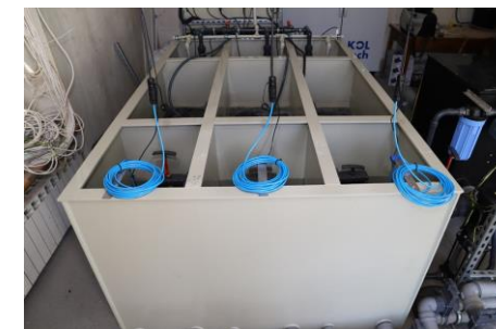
stacja uzdatniania wody biofiltr
