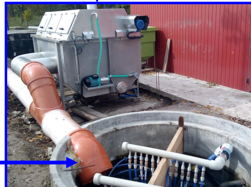
studnia do schładzania i napowietrzania wody
